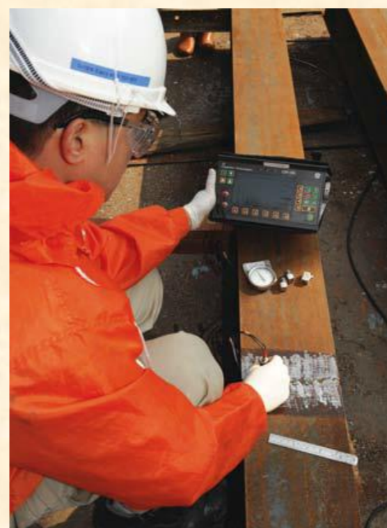
工字梁连接接头的内部缺陷检查
